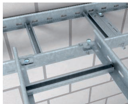
Montáž odbočení T Zhotovení vodorovné odbočky T u dvou kabelových žebříků probíhajících v rozdílných výškách. Pro vzájemnou fixaci kabelových žebříků je potřebný úhelník typu LAW.
